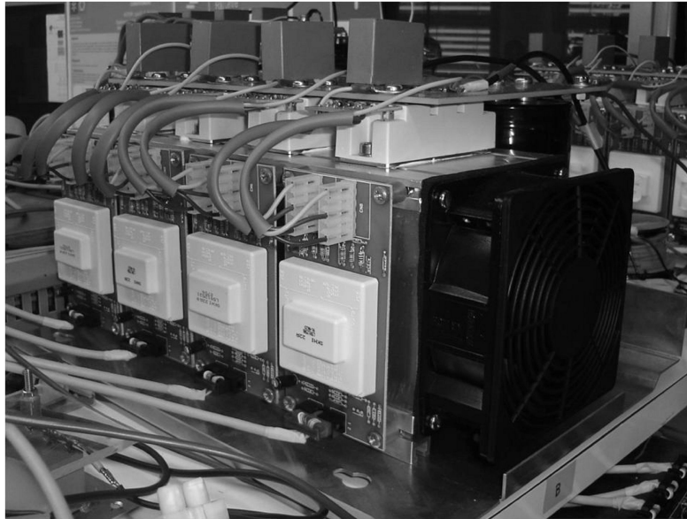
Fig. 6.18 Conversor de potência utilizado em uma das fases do UPQC.
