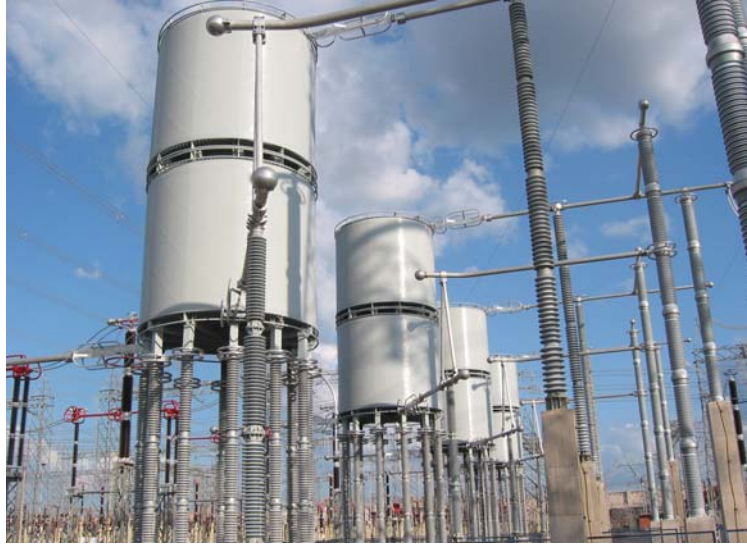
Figura 3 – Reator limitador da SE de Tucuruí 500 kV
