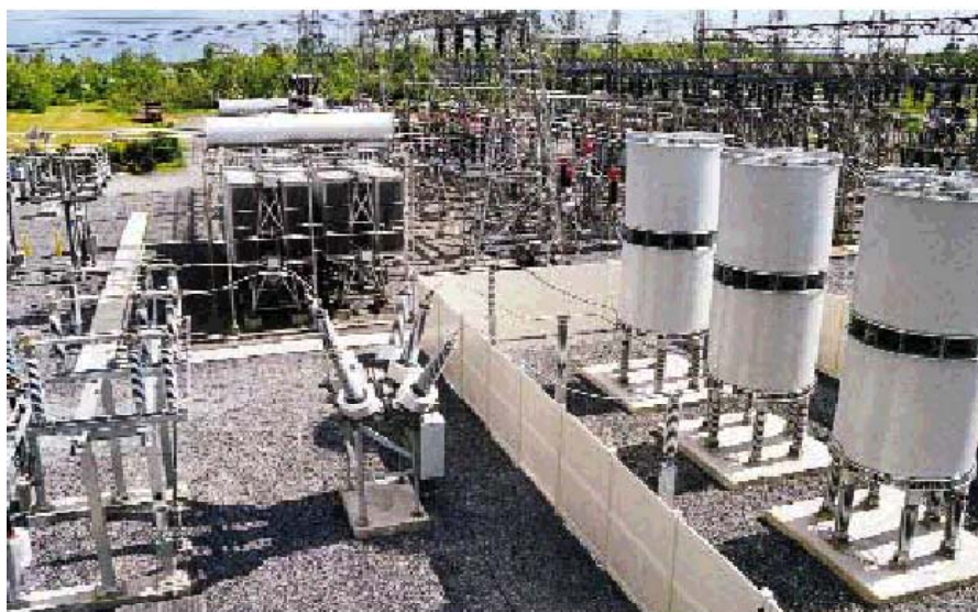
Figura 25 – Foto do IPC 315/120 kV na subestação de Plattsburg, em Nova York.
